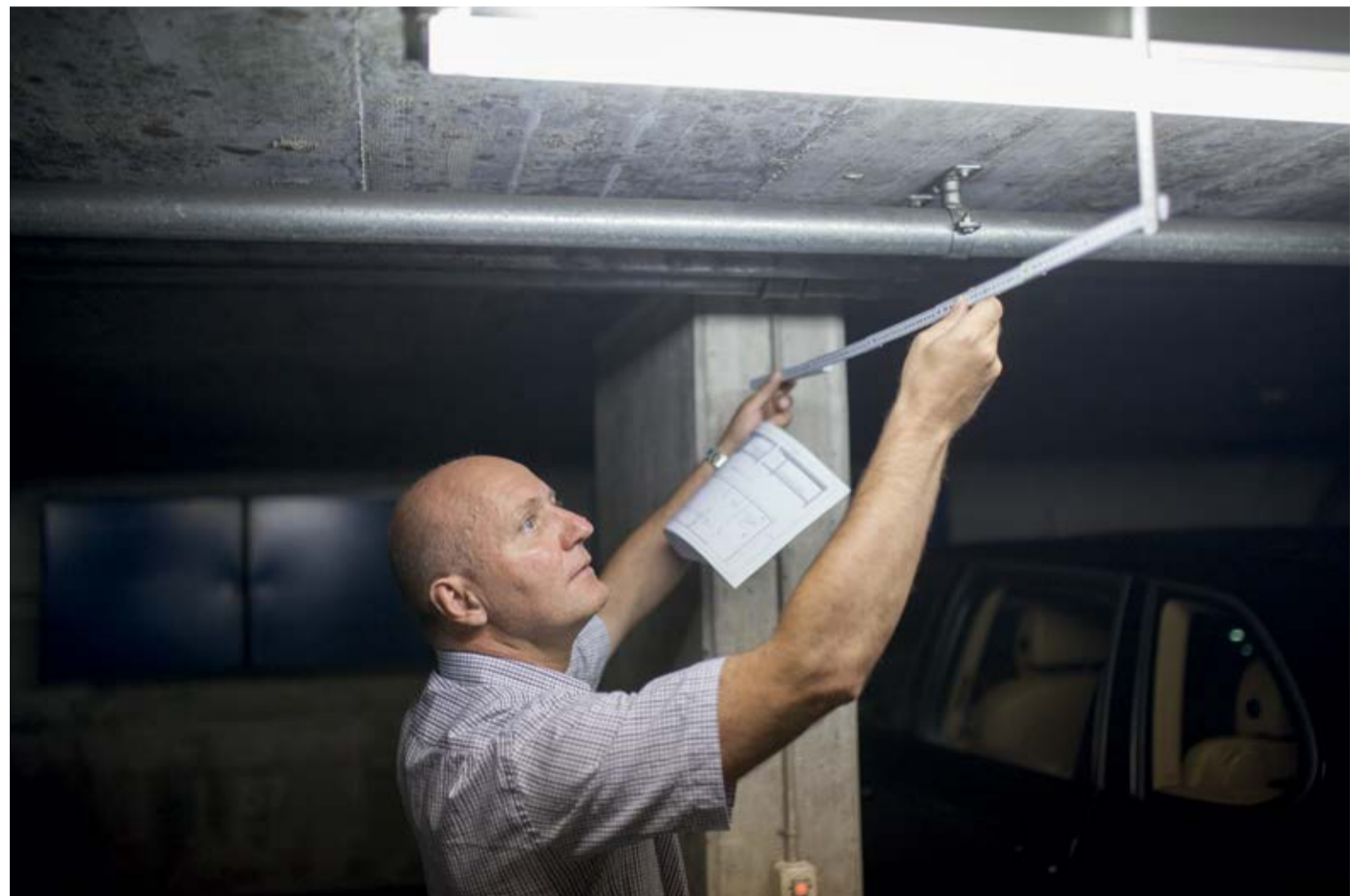
BILD Christoph Bernet erklärt: Im oberen Zwischengeschoss der Tiefgarage wird die Decke im Bereich von fünf bestehenden Stützen verstärkt
