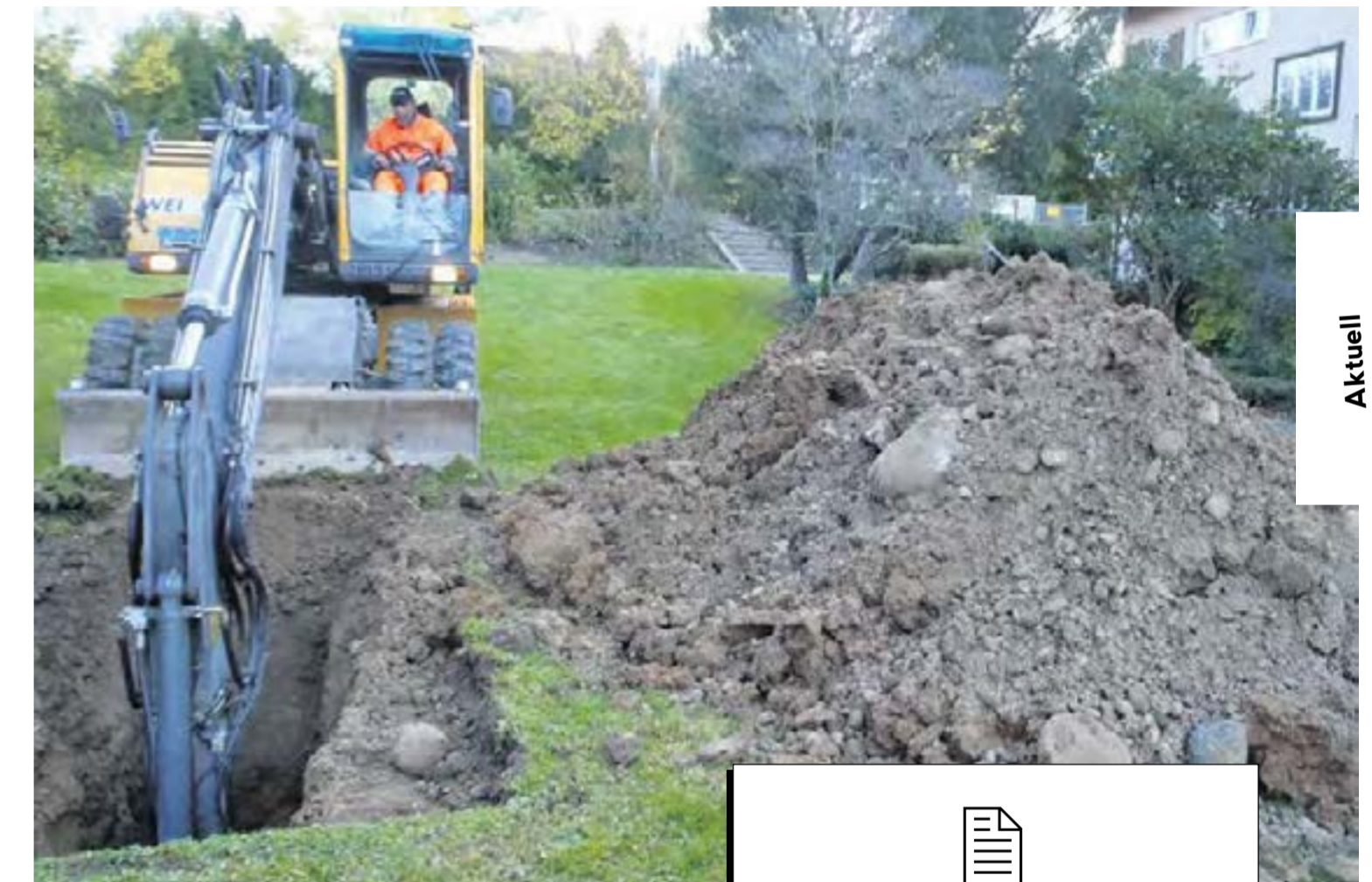
Um genaue Informationen bezüglich des Baugrunds zu erhalten, wurden an der Grenze des Areals Sondierschächte ausgehoben
